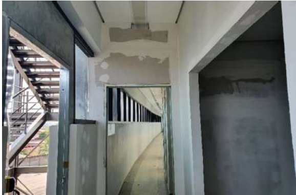
Foto 19 - Fechamento das aberturas com drywall e instalação dos batentes das portas do corredor de
