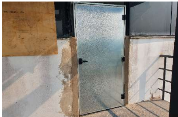
Foto 13 - Parte externa da porta corta fogo.
