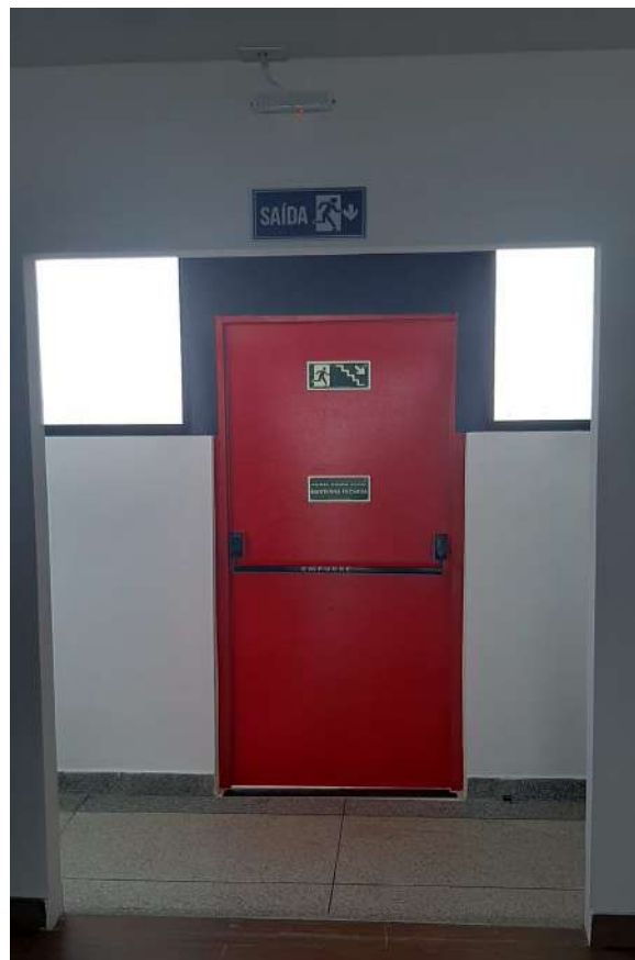
Foto 26 - Portas corta fogo com sinalização e iluminação de emergência - acesso interno.
