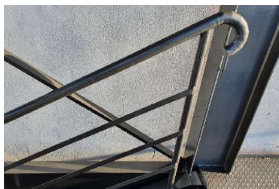
Foto 6 - Detalhes na pintura do guarda corpo.
