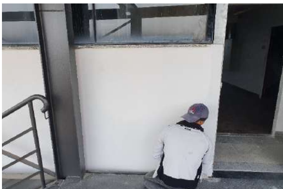
Foto 23 - Emassamento dos cantos do vão aberto para assentamento das portas corta fogo.
