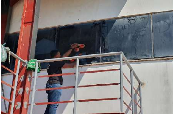
Foto 7 - Remoção das janelas de vidro, para abertura do vão da porta corta fogo.
