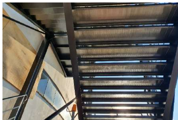
Foto 4 - Pintura sob os degraus da escada.
