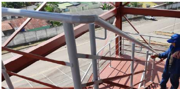
Foto 1 - Pintura de proteção - galvite e zarcão.
