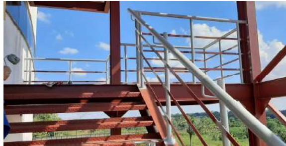
Foto 2 - Pintura de proteção - galvite e zarcão.
