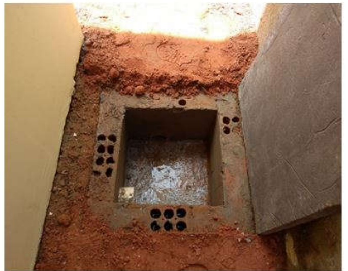
Foto12: caixa de passagem dos sanitários.
