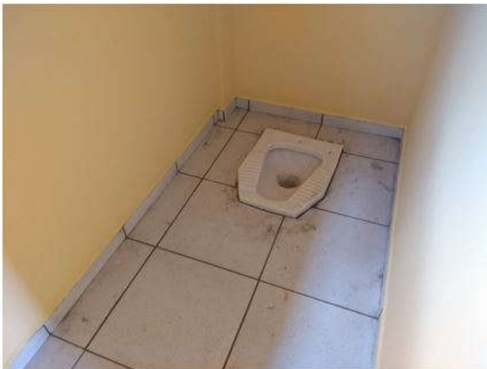
Foto11: bacia sanitária tipo turca instalada e em funcionamento.
