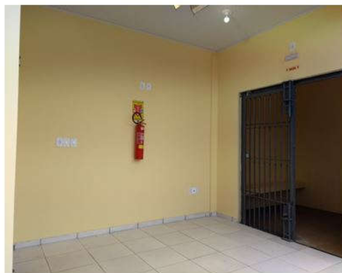
Foto8: vista da área de acesso do prédio das celas com extintor de incêndio instalado.
