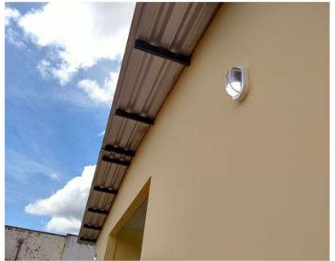
Foto2: Iluminação externa com arandelas.
