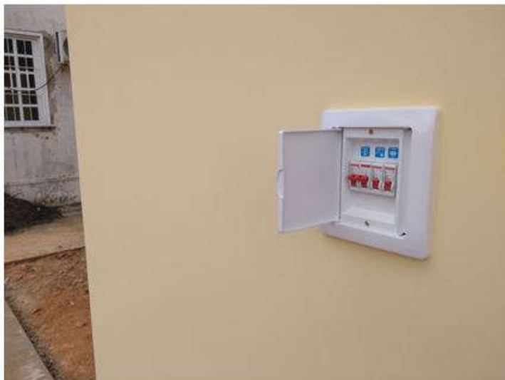
Foto5: quadro de comando do prédio da cela.
