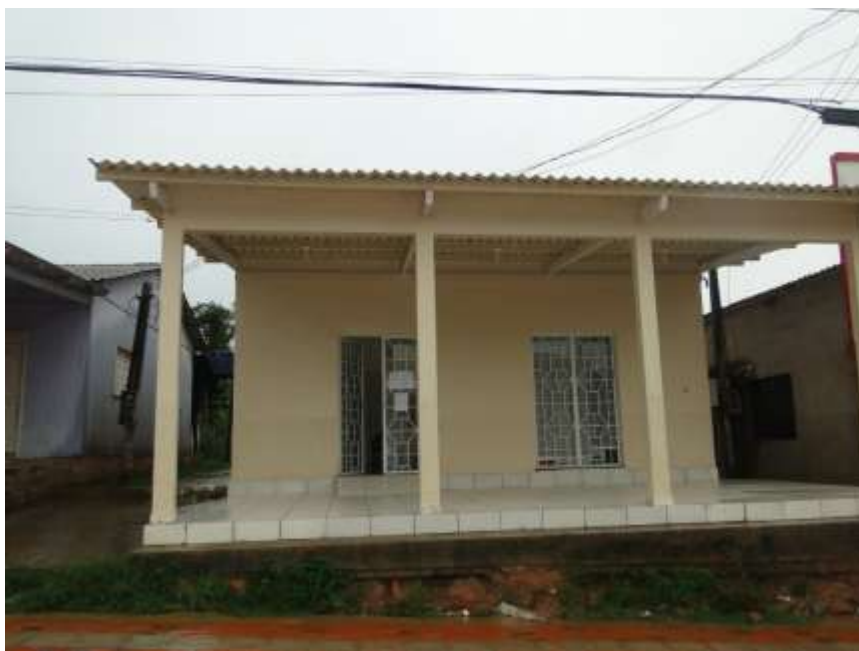
Fachada Principal da Serventia – Sem identificação e sem acessibilidade
